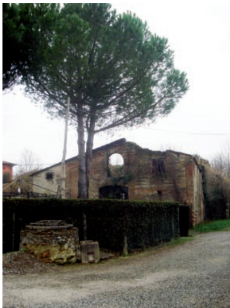
Casa poderale rovinata con un pozzo in località Le Colombaie (gennaio 2009).
